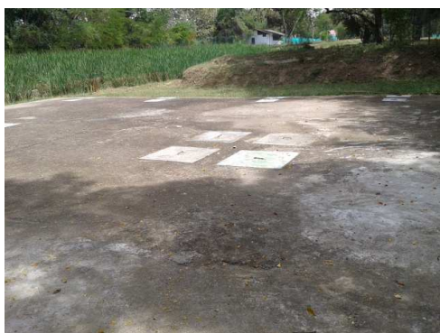
PTAR (Recolector de grasas)
